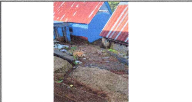
Foto 5: Estado actual de las gradas que conecta el módulo I con la cocina, representando un peligro para los miembros de la comunidad educativa. No cuentan con los pedales necesarios. En épocas de lluvia representan
