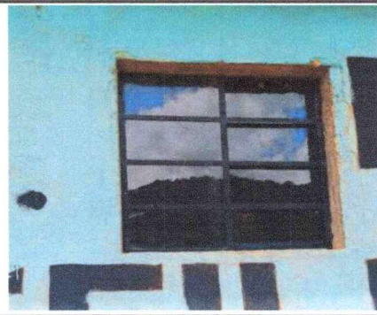
Foto 2: Evidencia del tamaño de las ventanas de prepa 3. Medidas que evitan la claridad dentro del salón de clases.
