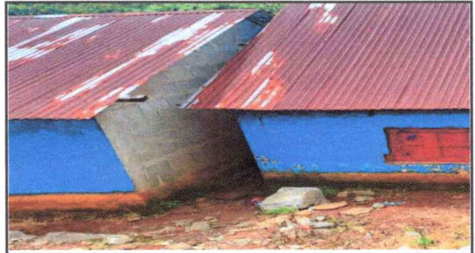
Foto 4: El salón de sexto primaria, tambien requiere cambio en la cubierta de lamina, en su mayoria se encuentran picadas dando lugar a las filtraciones de agua.
