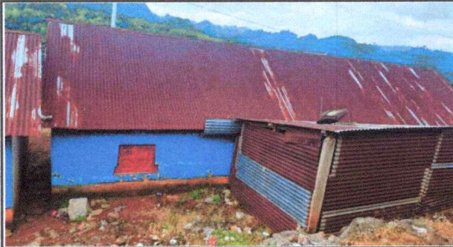
Foto 1: Se puede observar el deterioro de toda la parte estructural de la lamina del modulo que utilizan los educandos de 3° y 4° primaria. Tambien es necesario algun tipo de repello y aplicación de pintura.
