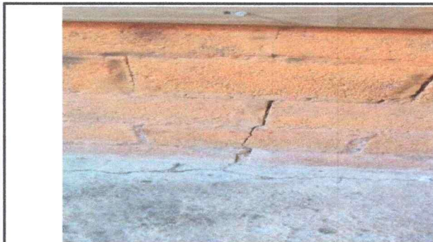
Foto 5: Evidencia del entortado del piso del modulo de tercero y cuarto. Requiere cambio por las malas condiciones en el que se encuentra.
