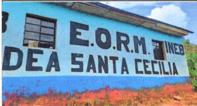
Foto1: Se puede observar las ventanas del salón de prepa 3, el mismo problema no cuentan con las medidas necesarias para que brinden iluminación y favorezcan proceso de enseñanza aprendizaje.
