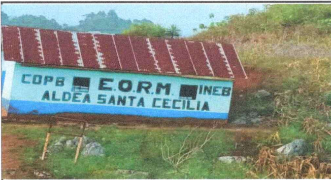
Foto 3: El salon de prepa 3, requiere cambio de toda la cubierta de lamina, presenta filtración de agua en varias partes de la estructura.
