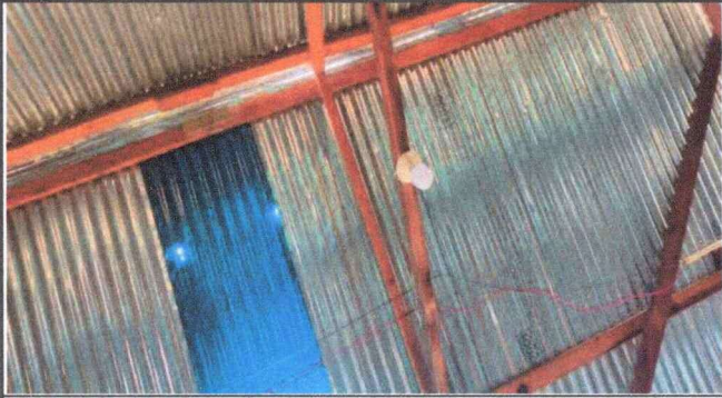
Foto 1: Actualmente cuenta con una única bombilla cada salón, esta no ilumina de buena manera los salones por lo que requerimos cambio de bombilla por una que tenga más potencia.
