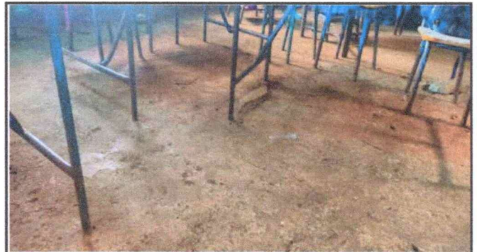
Foto 4: Evidencia del entortado de cemento del salón de tercero primaria.
