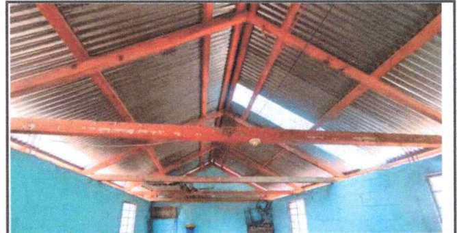
Foto 6: La estructura de la costanera del aula de sexto primaria, requiere cambio total por las condiciones deterioradas en las que se encuentran.
