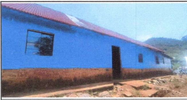
Foto 5: Las ventanas del tercero primaria, no cuentan con las medidas requeridas para brindar iluminación, por tal razón necesitan ampliación de las mimas.
