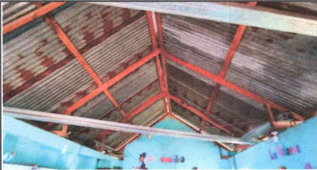
Foto1: Se puede observar el deterioro de toda la parte estructural de las costaneras que sostienen las laminas del salon de prepa 3. Requiriendo cambio total en toda la estructura.
