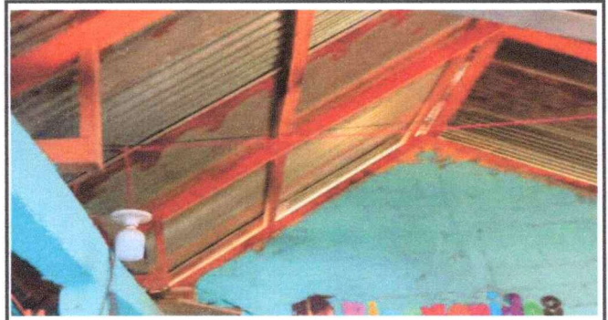
Foto 2: Evidencias de las costaneras que se encuentran en mal estado. Salón de prepa 3.
