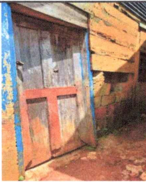
Foto 3: El salon de 4° primaria, necesita cambio total de toda su estructura física, actualmente cuenta con cinco hileras de bloc, y el complemento de madera. El block se encuentra agrietado en los cuatro lados del salón.
